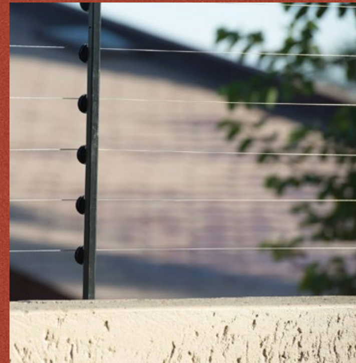
Barda perimetral electrificada
